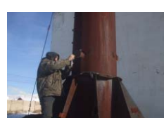
Төмөр зам ПДМС 鉄道修理場
